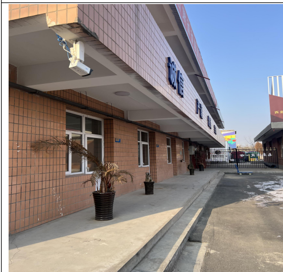
室外监控系统
